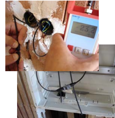
Eltern-Verteiler-Wohnz. 3 passive Verbindg 8 x biegen & Durchschleifen ~32m Kabel -3dBm / -23dBm
